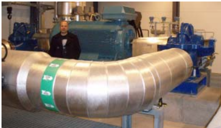
Distributions pumpar - Uddevalla Energi 2 st pumpar med gemensam ABB motor 2 x 1800 m 3 /h - 130 m
