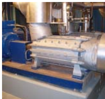
Matarvattenpump HZA 1526 192 m 3 /h - 185 m
